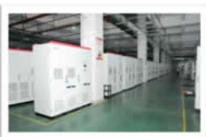
新能源光伏总装车间
